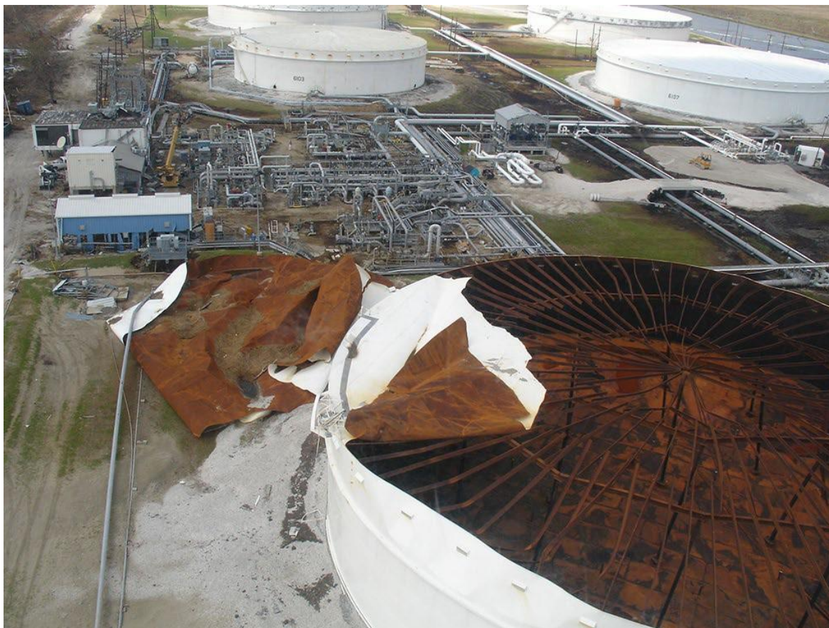
Фигура 8. Повреда на неподвжния покрив на резервоар за съхранение при обичайни условия, причинена от силен вятър.
