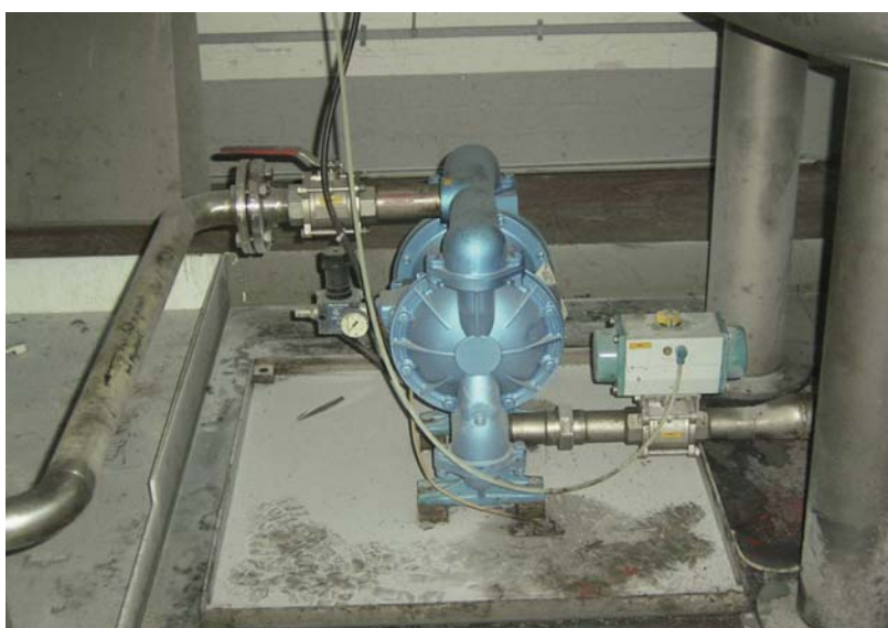
Фиг. 37. Защитена от експлозия помпа под налягане
