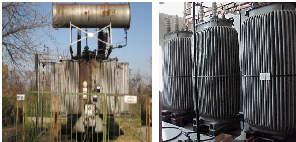
Снимка 1: Трансформатори в експлоатация, съдържащи РСВ, експлоатирани в България
