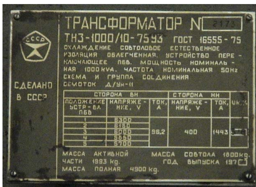
Снимка 2: Фабрична табела на руски РСВ трансформатор (Совтол) , експлоатиран в България
